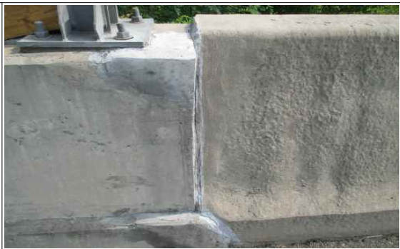
방호벽 상행선 A2측 접속도로 단차(약 3.0cm - 진전없음)
