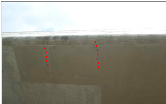
바닥관하면 대구방향 S1 보수부 균열 및 백태
