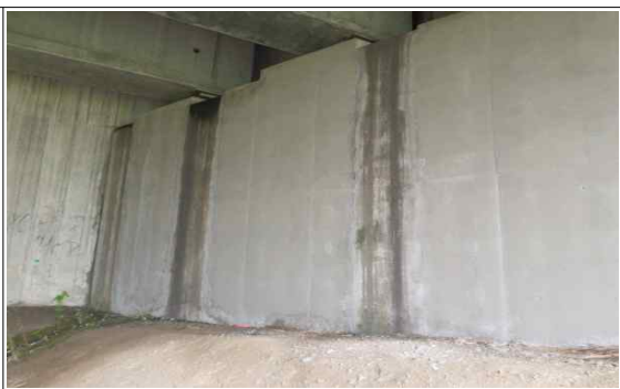
교대 상행선 A2 벽체 누수흔적
