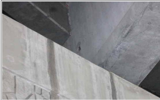
주형 상행선 S1 G1 인양홀 주위 콘크리트 손상
