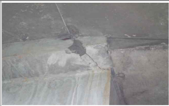
주형 하행선 G1(A1측) 지점부 콘크리트 국부손상
