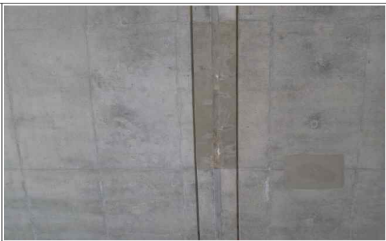
바닥관하면 대구·수성IC방향 S1 접합부 백태
