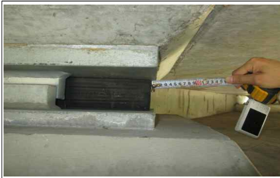
교량받침 하행선 A1 SH2 고무재 밀람
