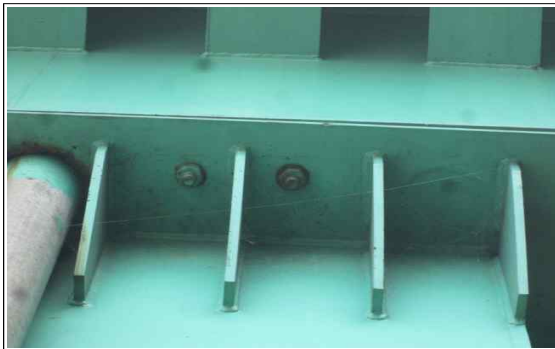
A2측 기둥 상부 볼트 녹발생
