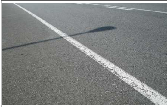
교면포장 상행선 S3 아스콘 균열
