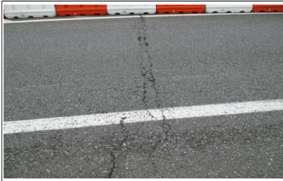
교면포장 대구방향 S1 아스콘 균열
