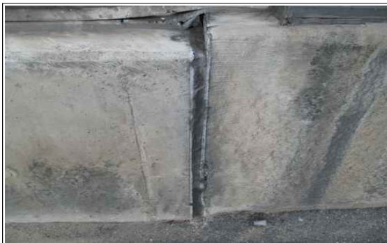
방호벽 하행선 A1측 접속도로 단차 및 실란트 손상
