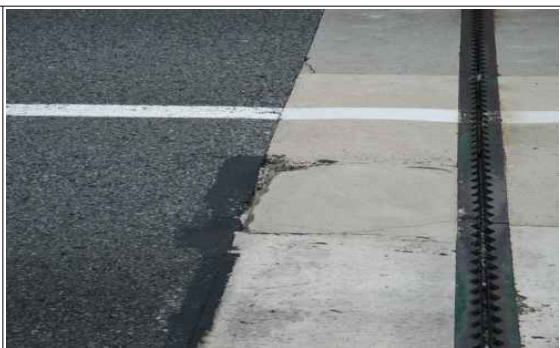
신축이음 상행선 A1 후타재 손상(보수부 재손상)
