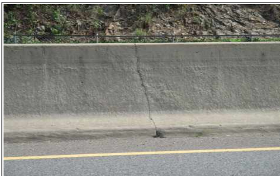
중분대 하행선 A1측 접속도로 균열(폭 0.5mm)
