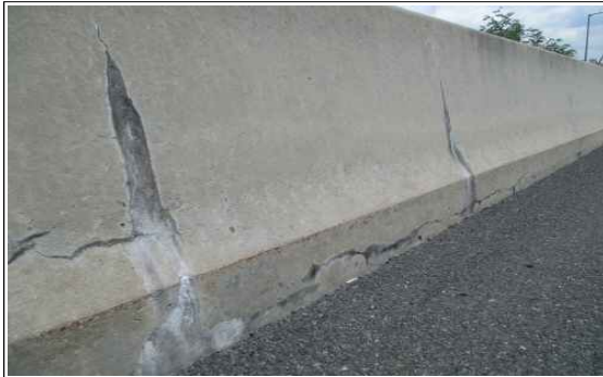
방호벽 대구방향 S1 균열부 백태
