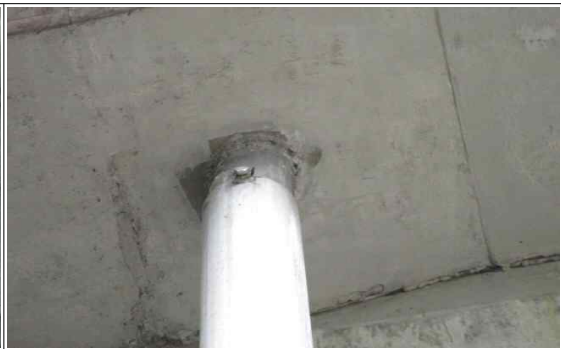
배수시설 바닥판 하면 배수관 접속부 백태
