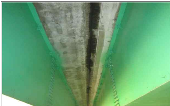
상·하행선 S1 바닥판하면 접합부 누수흔적 및 백태
