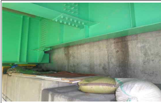
교대 상행선 A2 상면 이물질퇴적(자재적치)
