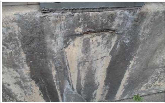
방호벽 상행선 S3 철근노출
