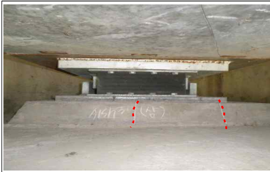
교량받침 상행선 A1 SH3 무수축물탈 균열(폭 0.1mm)
