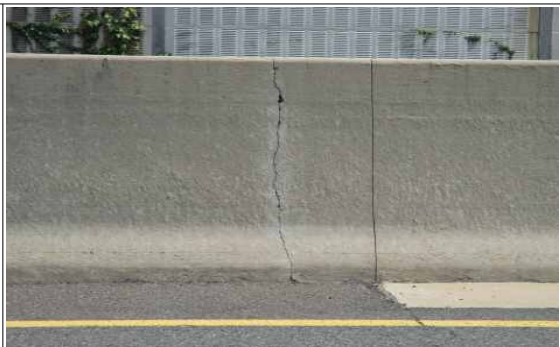
중분대 하행선 A1측 접속도로 균열(폭 0.5mm)
