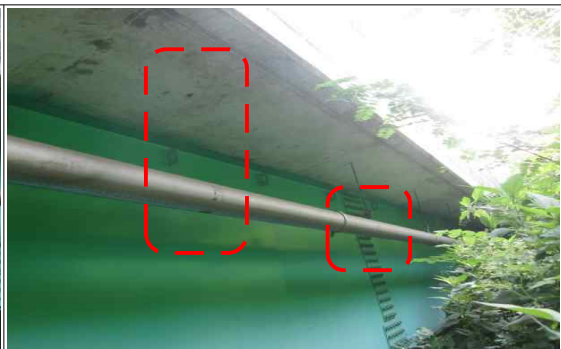
배수시설 하행선 S1 배수관 연결고리 및 연결재 탈락
