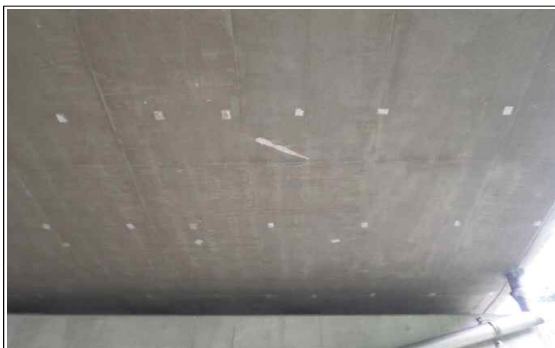
바닥판하면 하행선 S4 콘크리트 손상
