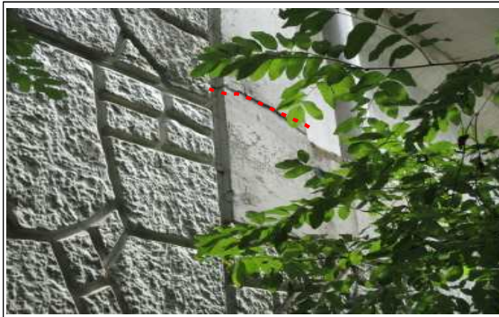
교대 A2 날개벽 균열
