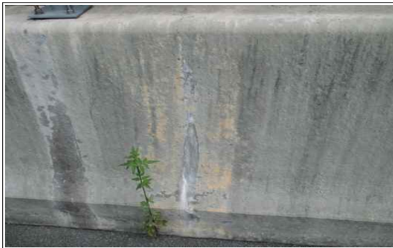
방호벽 S1 균열부 백태
