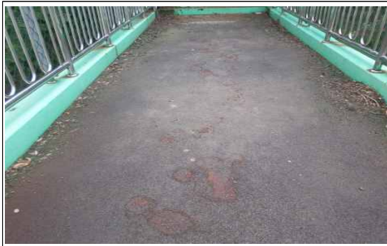
교면포장 S1 패임
