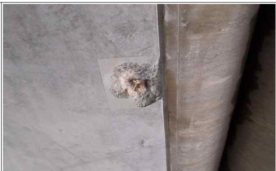
상행선 S3 바닥판하면 콘크리트 손상
