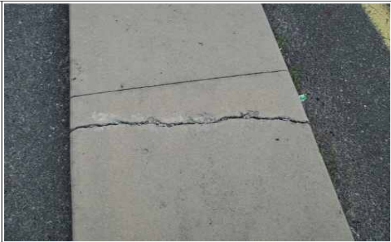
중분대 대구·수성IC방향 S1 균열(폭 1.0mm)
