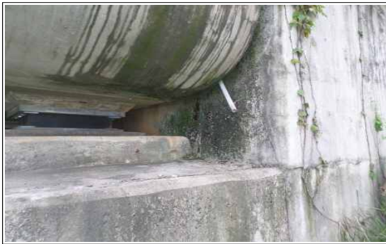
배수시설 상행선 A2 유도배수관 길이부족
