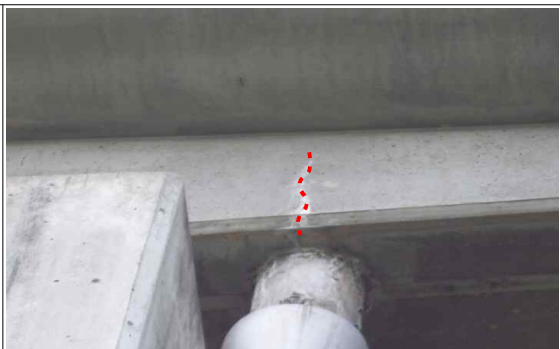
바닥판하면 상행선 S2 균열부 백태
