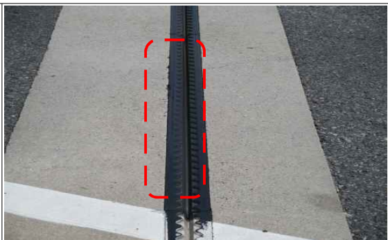
신축이음 하행선 A2 본체 고무재 손상
