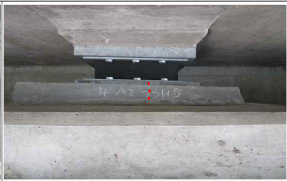
교량받침 하행선 A2 SH5 무수축물탈 균열
