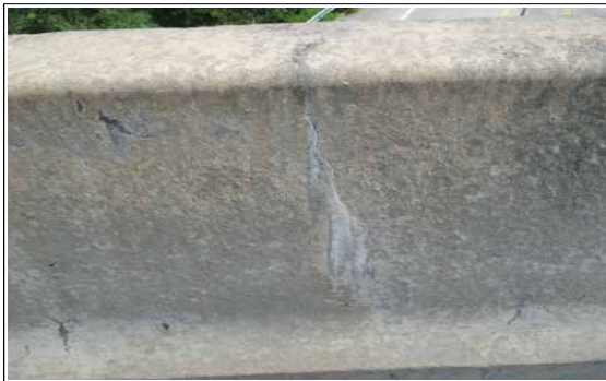
방호벽 교면포장 상행선 S2 균열부 백태
