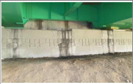
교대 하행선 A2 홍벽·벽체 누수흔적
