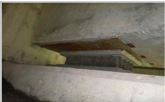
교량받침 상행선 A1 SH5 Plate 녹발생
