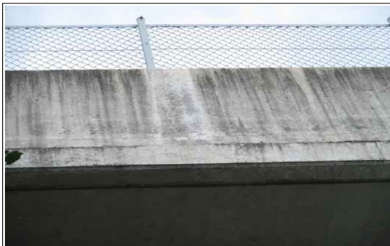
바닥판하면 S1 방호벽 방호벽 접속부 백태
