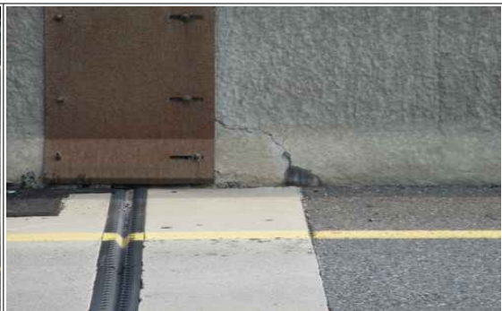
중분대 하행선 A1측 접속도로 콘크리트 손상
