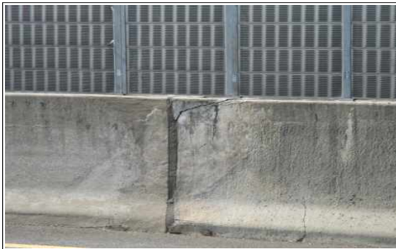
중분대 상행선 A1측 접속도로 콘크리트 손상
