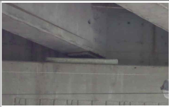
교량받침 상행선 A2 SH1 Plate 녹발생
