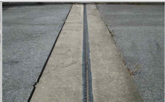
신축이음 A1 후타재 균열(폭 0.2mm)
