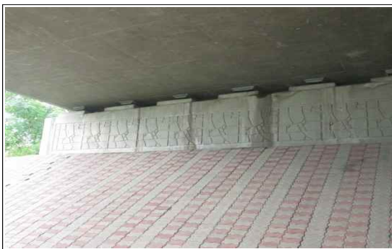
교대 상행선 A1 벽체 누수흔적
