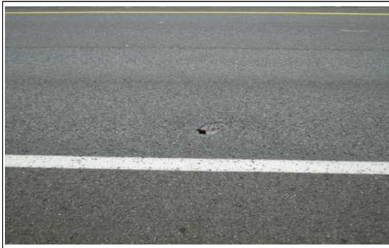
교면포장 상행선 A2측 접속도로 패임
