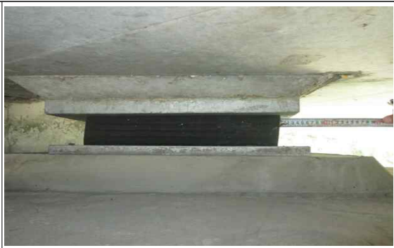
교량받침 하행선 A1 SH1 고무재 밀람
