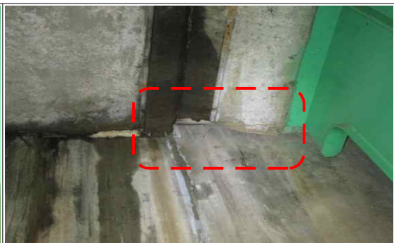
하행선 S1 바닥판하면 콘크리트 손상
