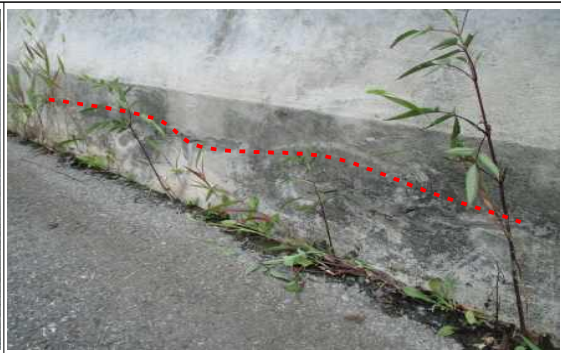
방호벽 S1 균열(폭 0.3mm)
