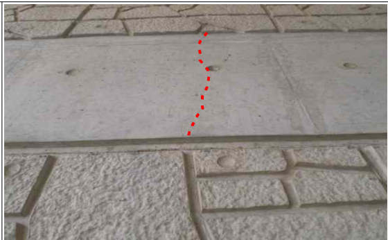
대구방향 A2 벽체 균열(폭 0.2mm)
