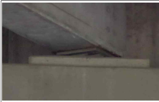
교량받침 상행선 A1 SH1 Plate 녹발생
