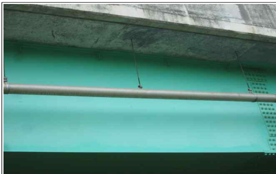
배수시설 상행선 S1 배수관 연결고리 탈락
