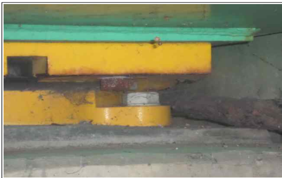
교량반침 하행선 A1 SH1 Plate 도장탈락 및 볼트 녹발생
