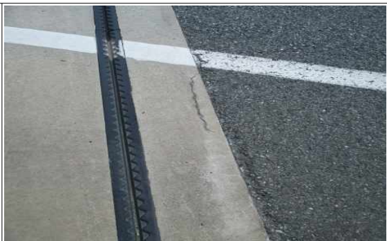
신축이음 하행선 A2 후타재 균열(폭 0.2mm)
