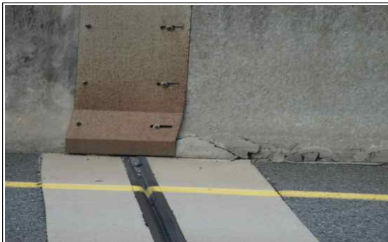
중분대 상행선 A2측 접속도로 콘크리트 손상
