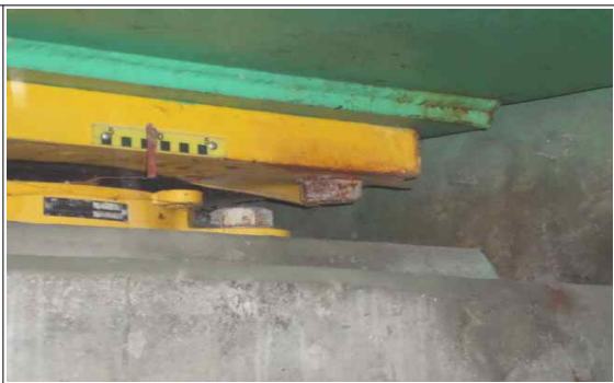
교량반침 하행선 A2 SH2 Plate 도장탈락 및 볼트 녹발생
