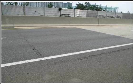
교면포장 하행선 A1측 접속도로 아스콘 균열
