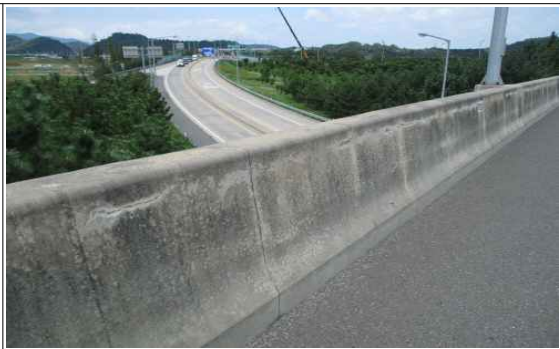
교면포장 하행선 S3 라벨링 균열부 백태
