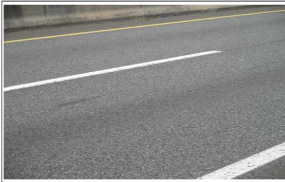
교면포장 상행선 S1 패임
