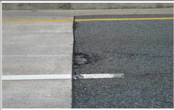
교면포장 하행선 A2측 접속도로 패임
