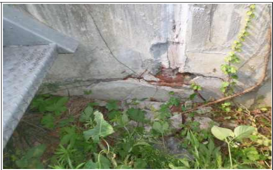
상행선 A1 우측 날개벽 콘크리트 손상
