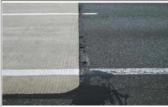
교면포장 상행선 A1측 접속도로 아스콘 패임
